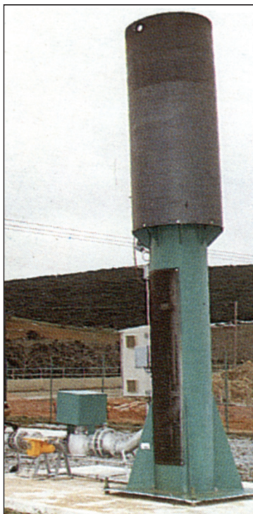
Μονάδα άντλησης και καύσης βιοαερίου
