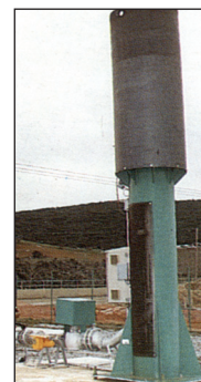
Μονάδα άντλησης και καύσης βιοαερίου
